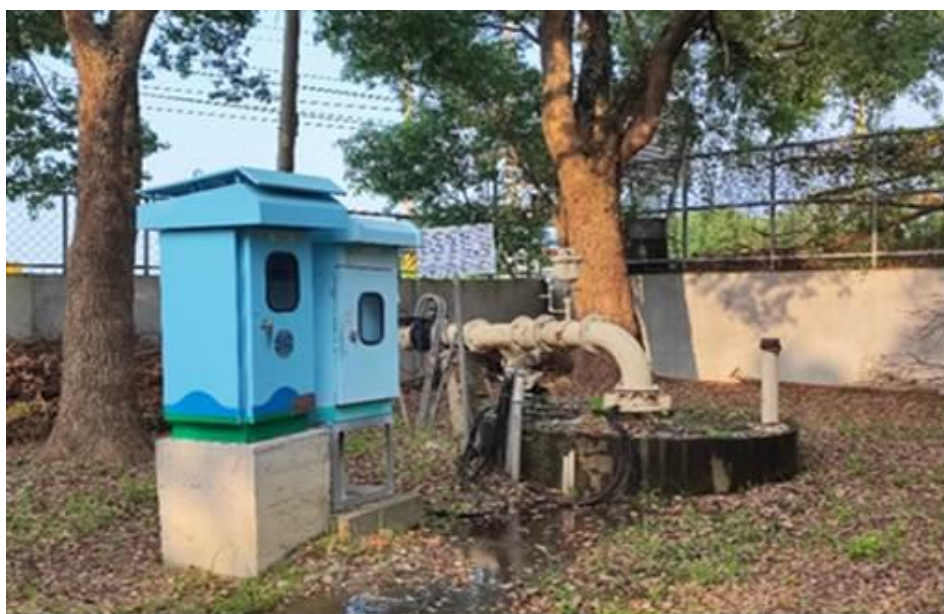
照片 11 台水公司第五區管理處抗旱水井功能測試現場照片
