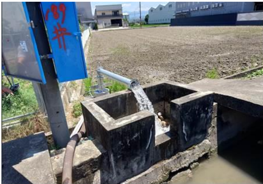
照片 15 農田水利署南投管理處抗旱水井功能測試現場照片
