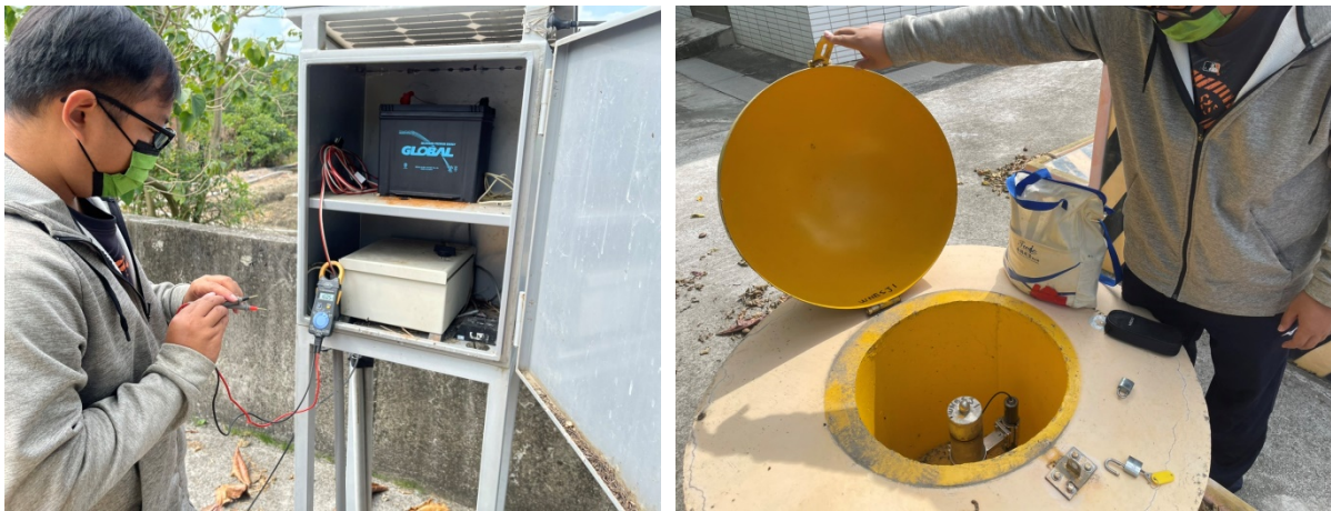
灣內國小深層水準樁設備維護(含儀器箱、樁位保護台清潔)
