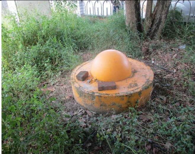
維護前現場景況
