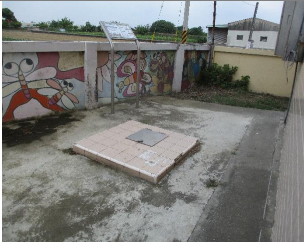
維護前現場景況
