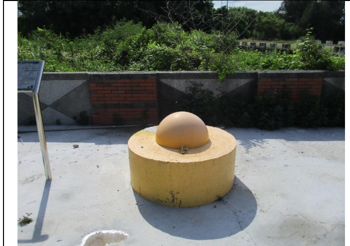
維護前現場景況
