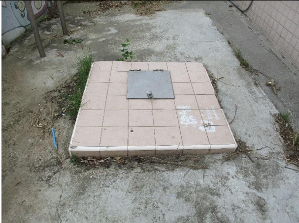
維護前現場景況
