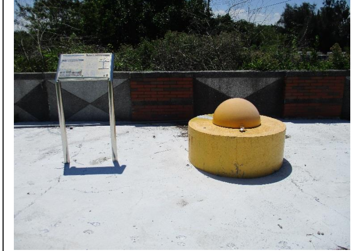
維護前現場景況
